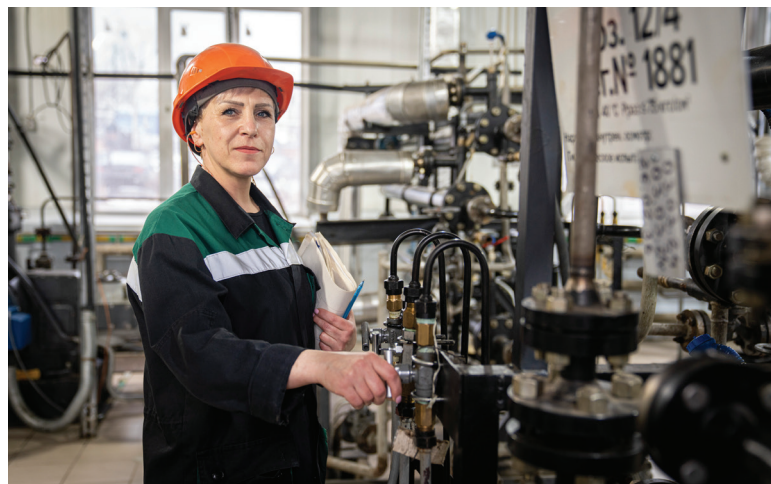
▲ Участок по производству жидкой углекислоты цеха газового сырья
