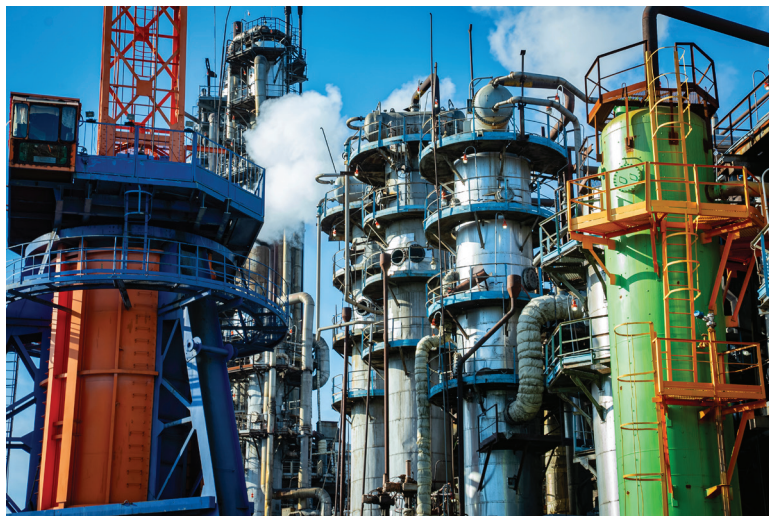
▲ Аппараты позиции 901 Г1/Г2 — важное технологическое оборудование цеха аммиака-2
