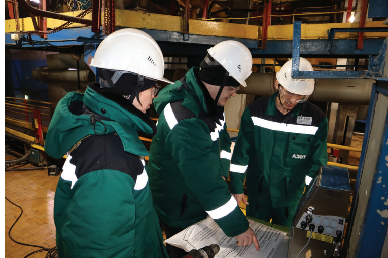
▲ Настройка маркера на участке азотной кислоты реактивной (ЦГС)
