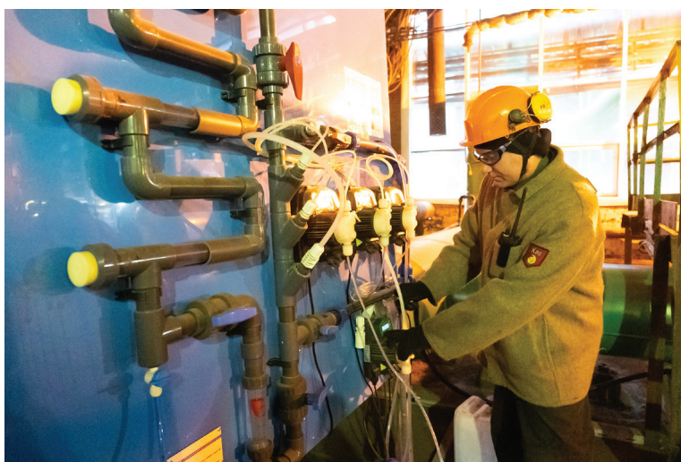
▲ Система коррекционной обработки воды — это конструкция, состоящая из насосов, трубок и ёмкостей для автоматического ввода в оборотную воду активных веществ
