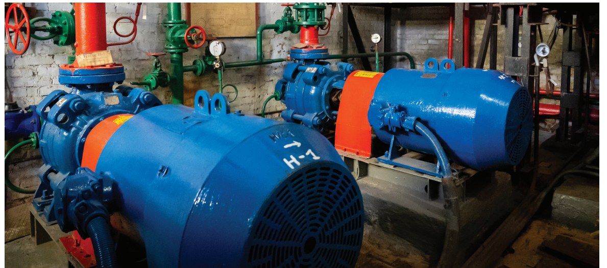
▲ Покрашенное оборудование в корпусе 946
