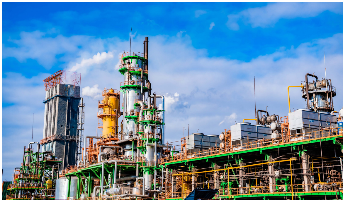
▲ Оборудование производства ИКЦ уже успешно эксплуатируется в цехе аммиака-1
