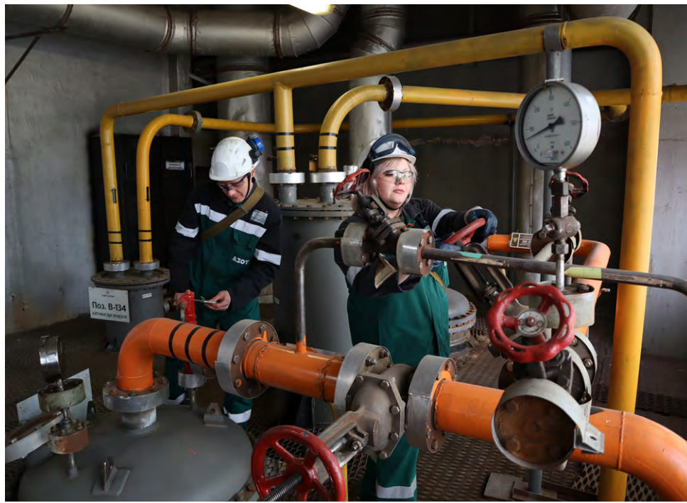
▲ Покраска, маркировка оборудования теперь помогут даже новичку без проблем ориентироваться в технологическом процессе
